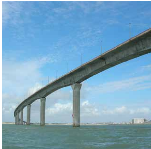
Certaines des méthodes répertoriées dans le cahier ont contribué à ausculter et surveiller des câbles de précontrainte du pont de l'Île de Ré. © Remi Jouan / Wikimedia Commons.
